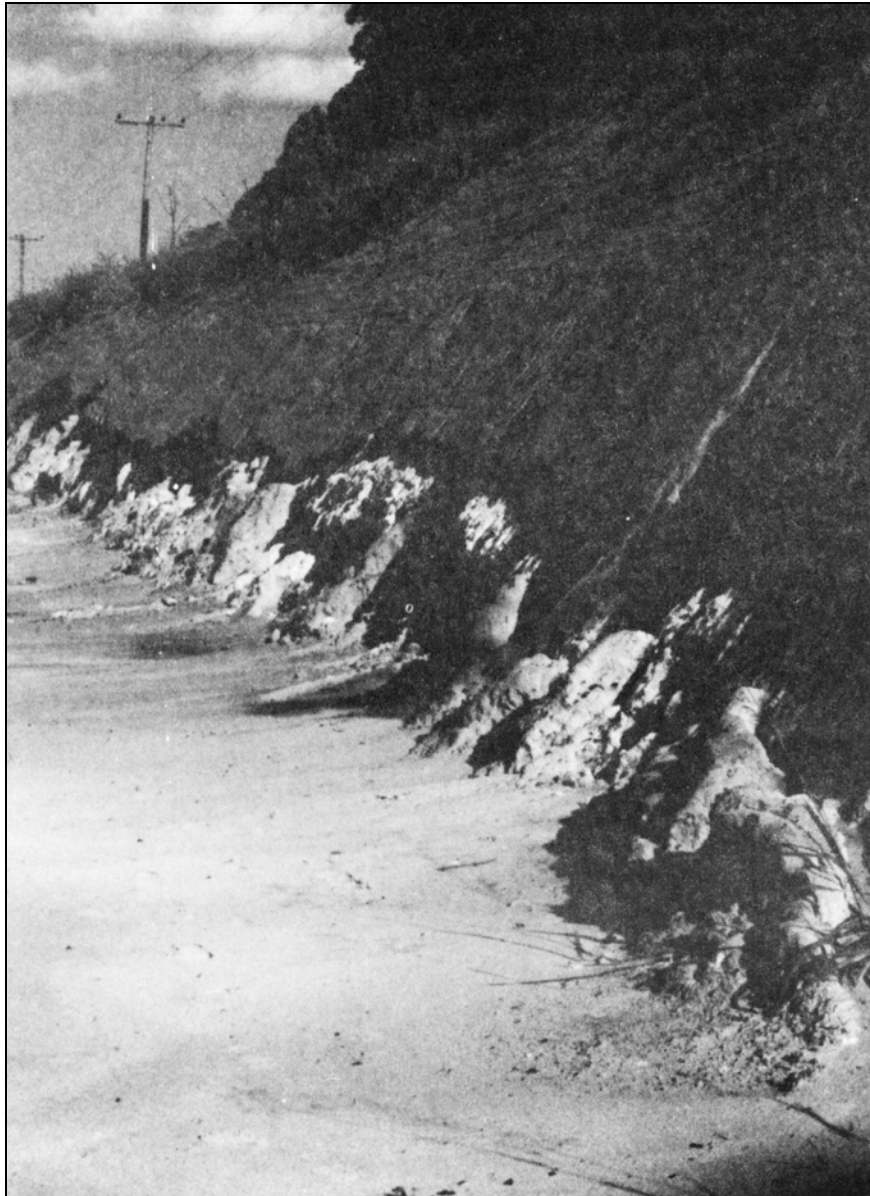
Erosão em talude de rodovia – Fonte IPT
