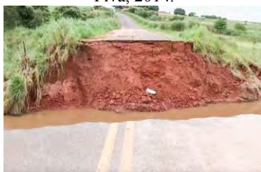
Figura 16: Rompimento de pista pela água na rodovia Alberto Lahoz de Carvalho, Sorocaba (SP). Fonte: Gazeta, 2016.
