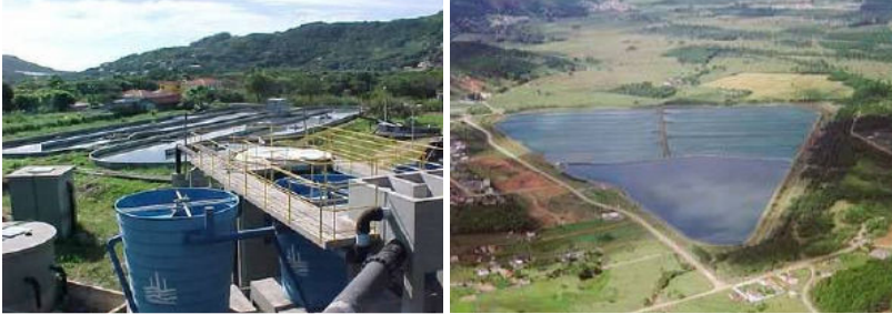
Figura 6 - Tratamento Secundário: Lodo Ativado de Valo de Oxidação, Lagoa da Conceição, Florianópolis (esq.) e Lagoa de Estabilização Anaeróbica e Facultativas, Potecas, São José/SC (dir.).
