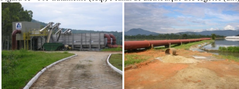
Figura 65 - Pré-tratamento (esq.) e canal de distribuição dos esgotos (dir.).
