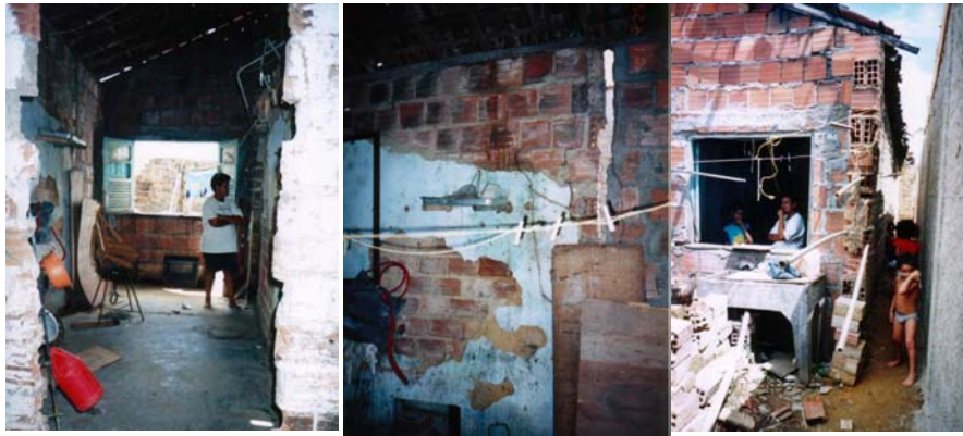
Figura 3- Fotos realizadas durante as vistorias a casas em risco. Fonte: Luciana Carvalho, 2001
