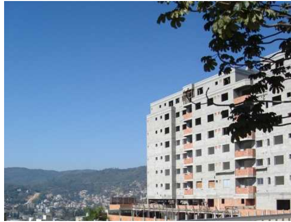
Figura 7: Prédio multifamiliar de alta densidade em construção na mesma rua. Fonte: Marlon Pscheidt, 2006
