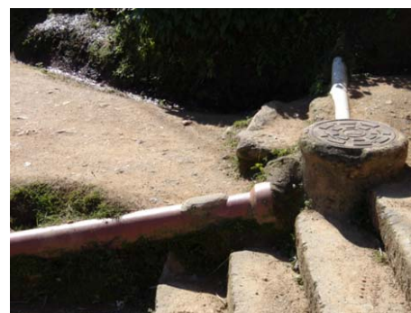
Foto 21: Tubulação aparente e saliente = mais suscetível a danos Foto: Priscilla Mandaji
