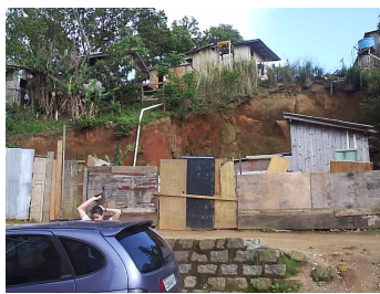
Fig. 10. Corte mal executado em terreno. Morro da Queimada. Fonte: autor, 2005.
