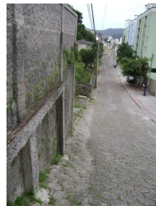
Figura 37: Interrupção do sistema de drenagem das águas pluviais– Rua José João Martendal.
